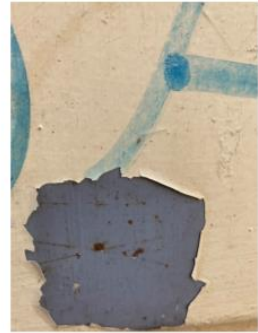
Opadané barvy a omítky odkrývají barevné plochy spodních vrstev
